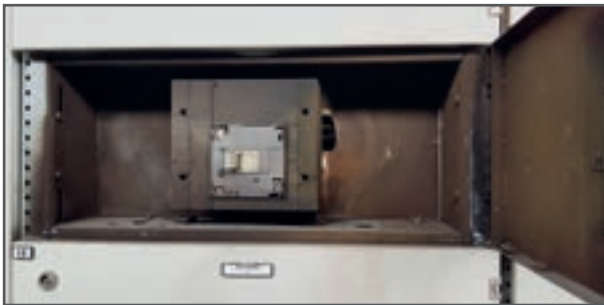
Arco interno cubicolo
