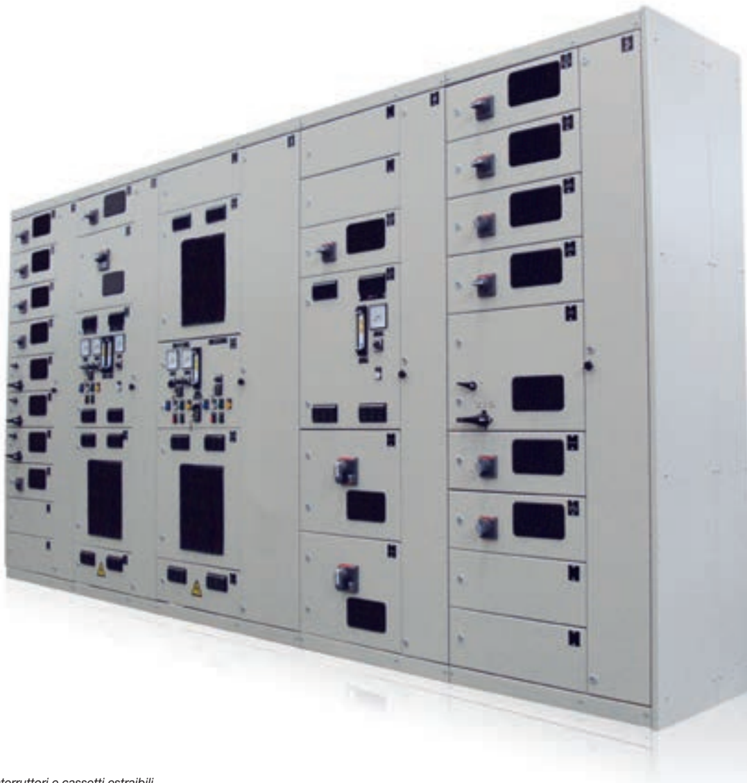
PMCC con interruttori e cassettei estraibili
