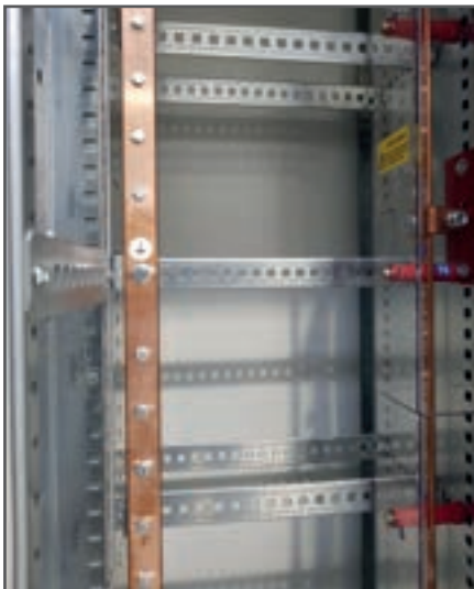
Particolare fissaggio cavi
